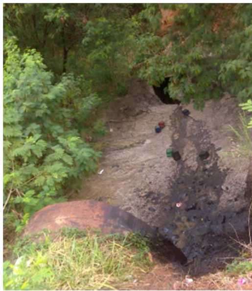
Foto 3.1 – Erosão do Maia
