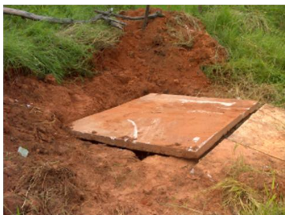
Foto 3.2 – Tampa da Caixa Coletora - Jardim Primavera
